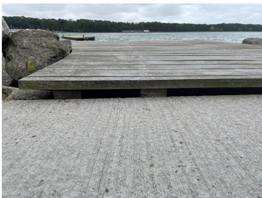
Figur 21 Eksempel på lokale sætninger ved Klimatorium Lemvig
